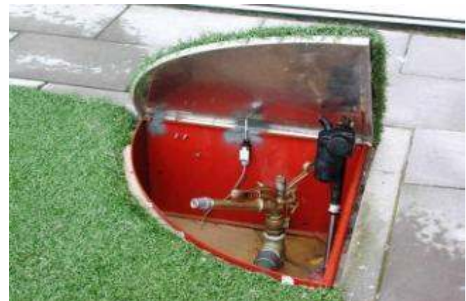
Aufbau von sechs Wassersprengern pro Feld
